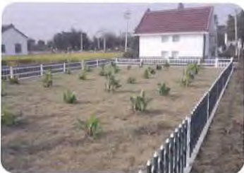
浙江省湖州市俞家埭村 污水处理站
